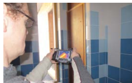
Repérage des entrées d'air froid à la caméra thermique
